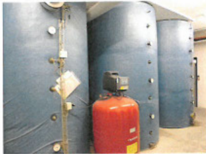
Maschinenraum mit drei Wärmespeicher á 6000 l der Tobl Seeobst AG in Bischofszell (CH).
